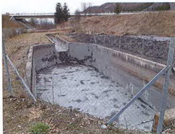
Photo 1. Curage réalisé en février 2021, 1,60 m de limon dans le bassin de décantation !!!
